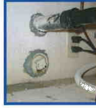
Fill Gaps & Holes
